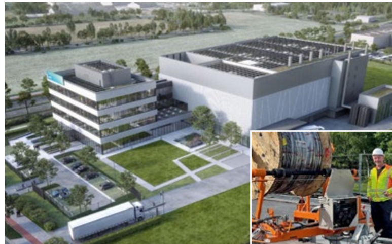
Beim Bau der Hightech-Fabrik von Jenoptik ist die AEK mit der kompletten Elektroinstallation beauftragt. Kleines Bild: Bauleiter Christoph B. beim Einrichten des Kabelwagens.
