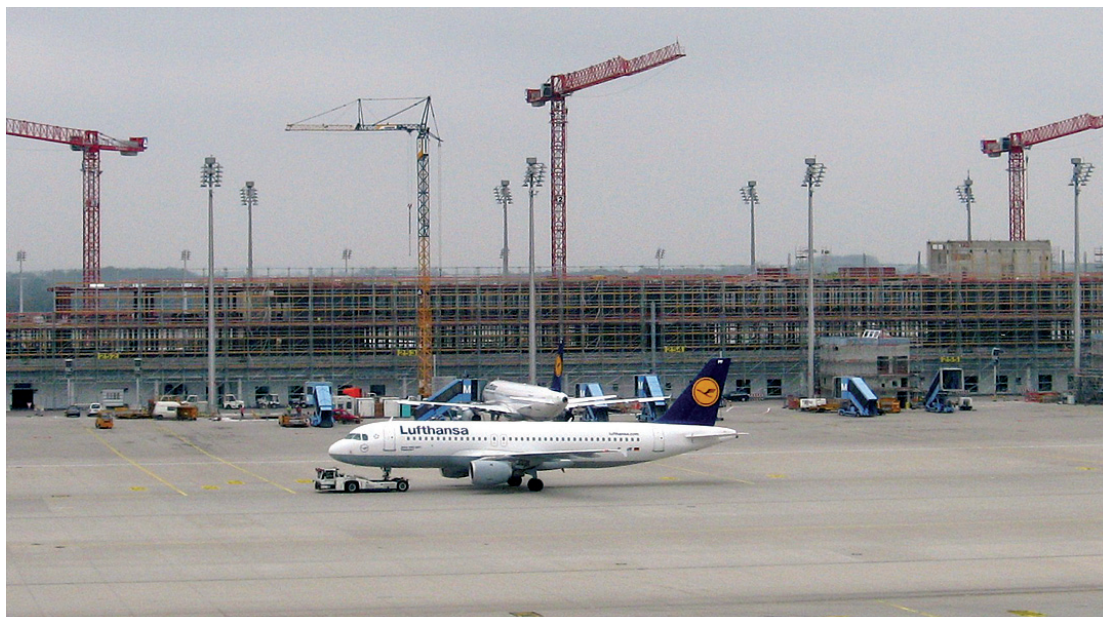
Die Flutlichtmasten für die Vorfeldbeleuchtung am Neubau des Flughafen-Satellitengebäudes.
