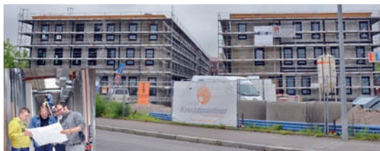
Im Schnitt bis zu 15 Monteure sind unter der Bauleitung von Markus Haller (kleines Bild, rechts) beim DIFAZ-Projekt beschäftigt.
