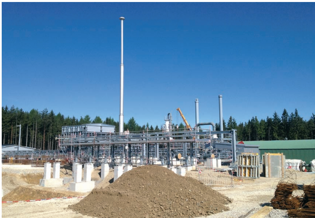
„Seven Fields II“ in Oberkling und Pfaffstätt/Oberösterreich: Bis Jahresende wickelt die Industrietechnik hier den mittlerweile vierten EMSR-Auftrag für das gewaltige Erdgas-Untergrundspeicher-Projekt der RAG Wien ab.
