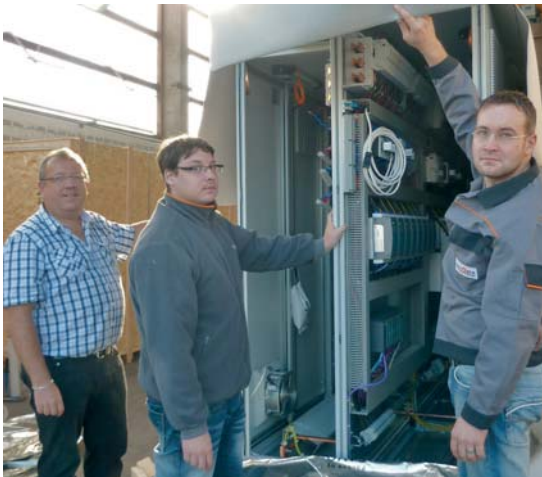
Auch 2012 werden (von links) Schaltanlagenbau-Leiter Alfred Aigner sowie die beiden Handwerksmeister Stefan Lechner und Stefan Kahlhammer wieder zahlreiche fertige Schalt-schranke „Made in Burghausen“ auf die Reise zu den Kunden schicken.
