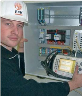
Projekt MHKW: André Richter bei der ODTR-Messung zur Prüfung der WLAN-Funktionalität.
