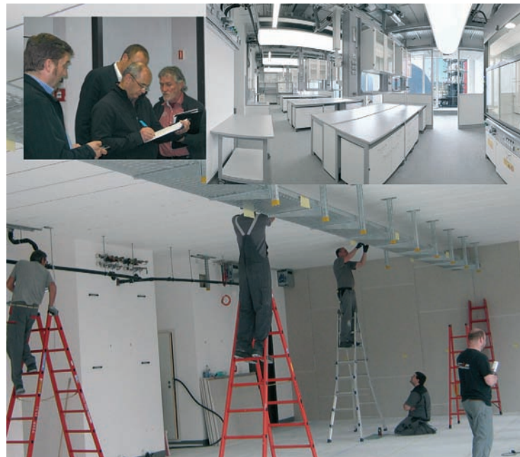
„Höchste Kreuzpointner-Qualität“ bei der Laborinstallation für die Universität Luxemburg: Das Industrietechnik-Team unter der Projektleitung von Anton Braun (kleines Bild rechts, bei der Endabnahme der Laborinstallation) in Aktion.
