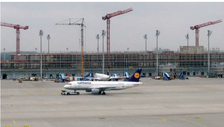
Zwei Großaufträge im einstelligen Millionen-Euro-Bereich beschäftigen die Gebäudetechnik bis Anfang 2015 am Neubau des Flughafen-Satellitengebäudes.
