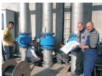
An der Eforie-Klärwerk-Baustelle: (von links) die AER-Mitarbeiter Nicu Pirpiliu, Martin Florin und zweiter von rechts Bauleiter Thorsten Scheck von der EFk.
