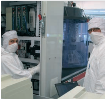
Tom Werner und Thomas Eckart bei der Inbetriebnahme einer Anlagenkomponente.
