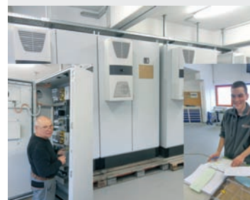
Rainer Schulze (links) und David Fuchs bei der abschließenden Funktionsprüfung für die Leistungsschränke eines Trockners.
