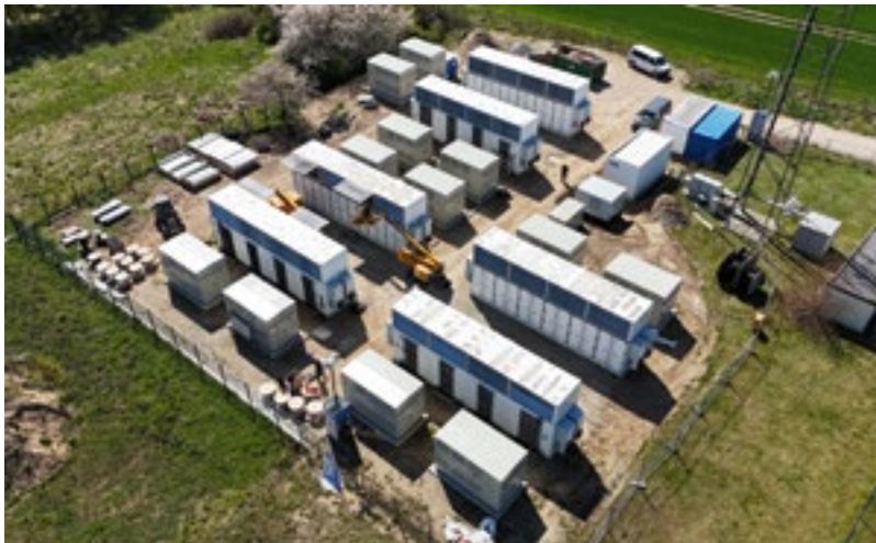
Aktuell im Bau durch Kreutznpointner energy ist ein Großbatteriespeicher an der Ostsee.
